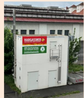
Biomasse-Heizmodul am Grünen Zentrum in Töging mit Heizanlage, Bunker und Schüttgasse.
